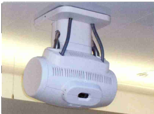
Caméra installée au plafond du local.
